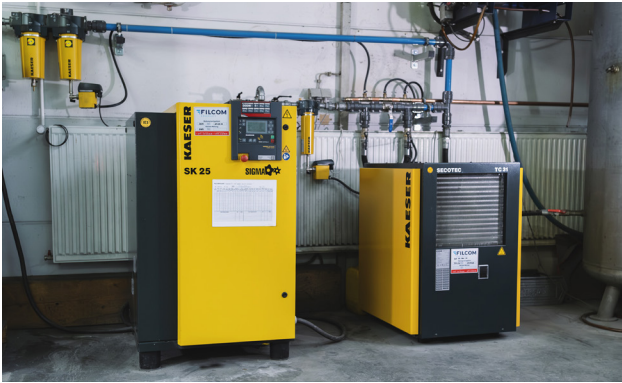
Die Druckluftstation bei Haimerl Lasertechnik Foto: FILCOM GmbH - O. Unrath
